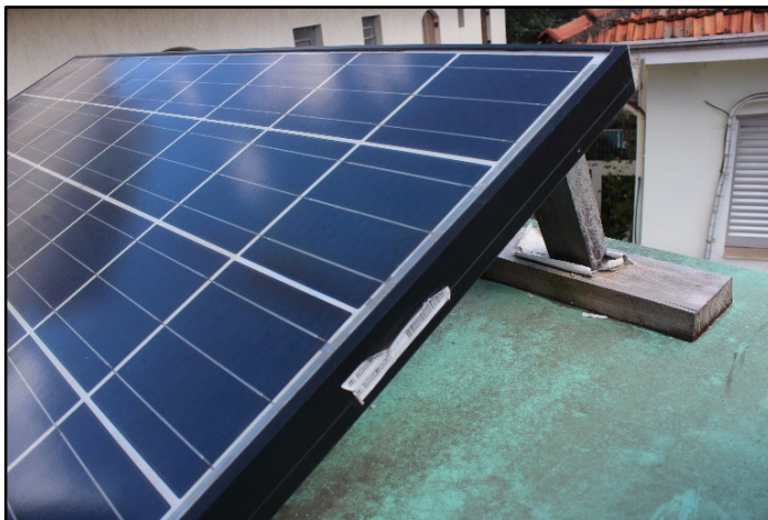
Figura 41 - Painel solar instalado em suporte
