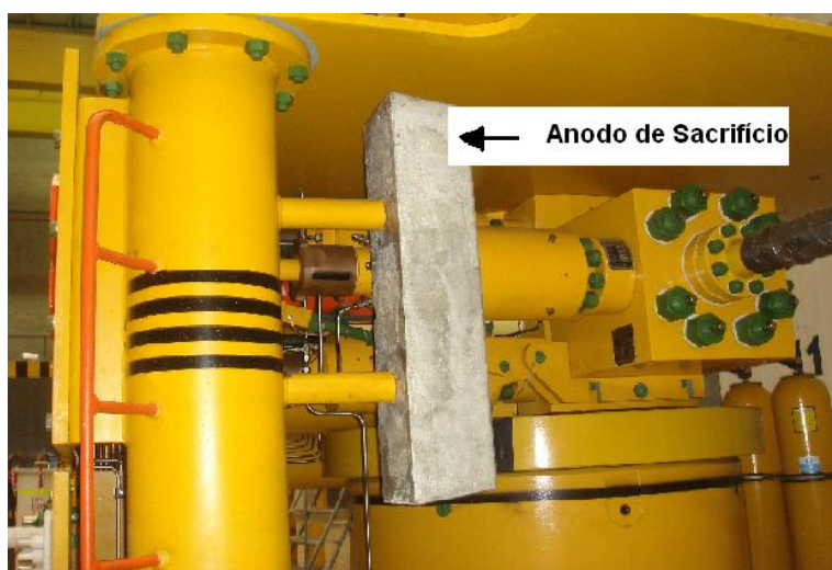
Figura 2: Detalhe do anodo de sacrifício de Alumínio soldado ao equipamento, gerando Hidrogênio para o sistema [imagem cedida pela General Eletric ].
