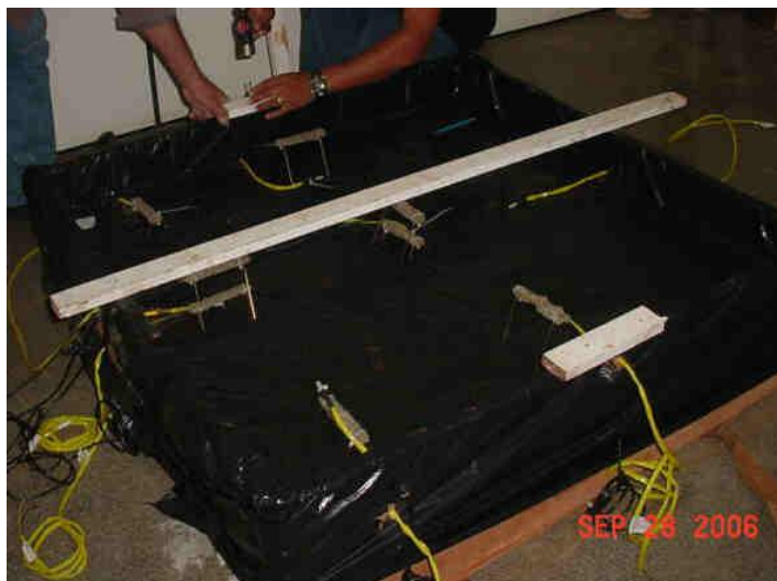
Fotografia 40. Colocação da manta plástica para evitar a aderência da placa de concreto. Vista do posicionamento dos sensores na placa e colocação de reforços nas paredes do molde.
