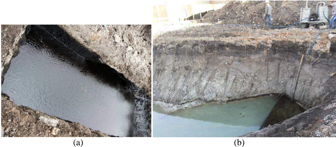
FIGURA 8 – (a) Cava mostra exposição do aquífero e formação da fase livre e (b) Confinamento da fase livre com boias flutuantes e bombeamento direto com o Sistema MPE móvel na cava principal. (ConAm, 2015b).
