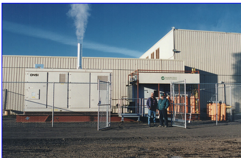
Figura 3-8 - Pilhas de ácido fosfórico instaladas no Alasca. O sistema gera 1 MW
