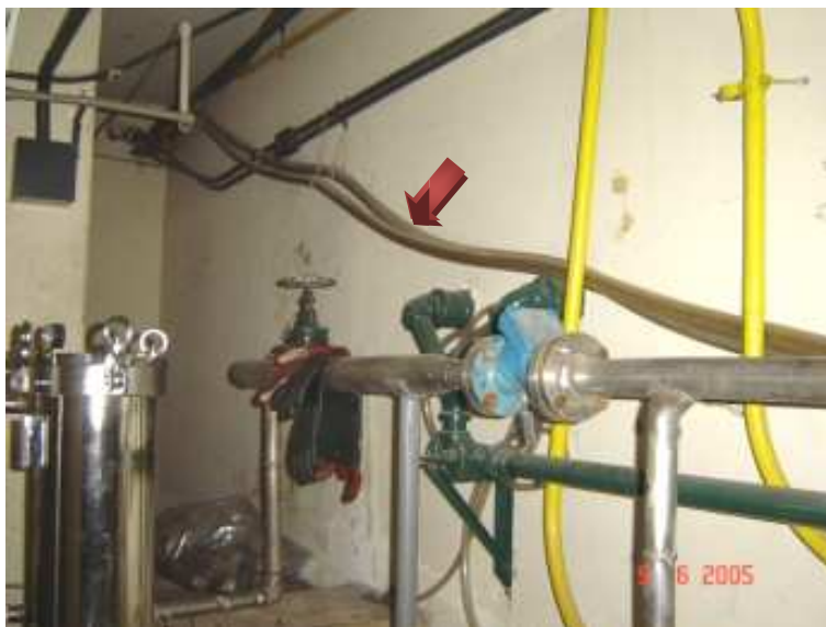
FIGURA 4.3 (b) – Tubulação do Antigo PTS Apoiada Diretamente na Parede sem Suportes
