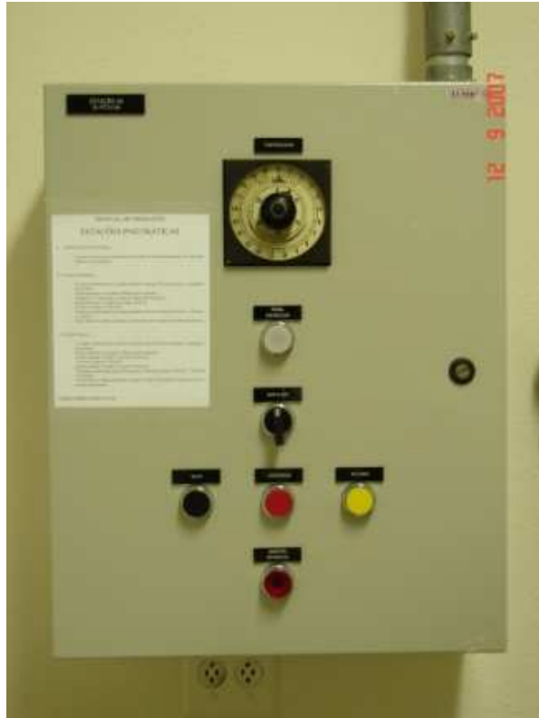
FIGURA 4.10 (a) - Painel de Comando do Novo PTS
