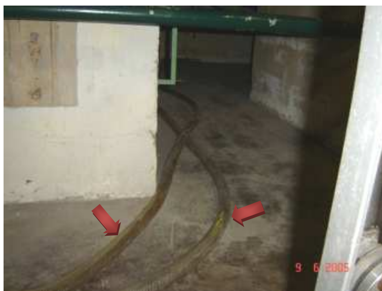
FIGURA 4.3 (a) – Tubulação do Antigo PTS Apoiada Diretamente no Piso
