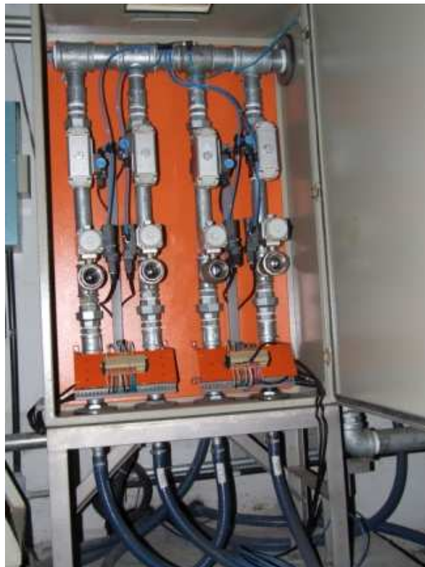
FIGURA 4.10 (b) - Painel de Válvulas Solenóides do Novo PTS
