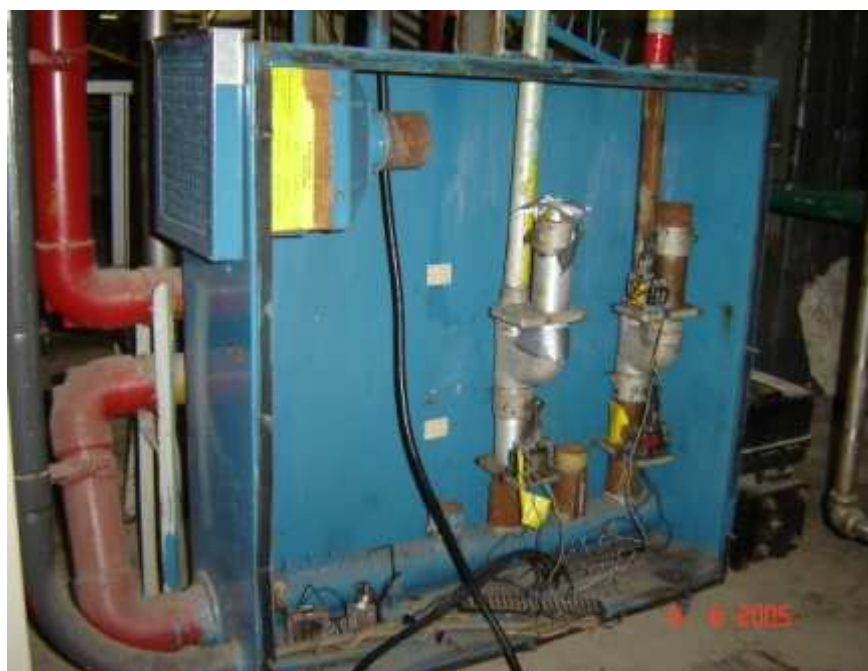
FIGURA 4.9 (b) - Painel de Válvulas Solenóides do Antigo PTS
