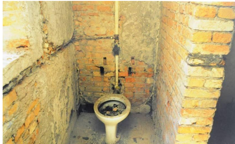
Figura 76 – Foto de uma das celas, com o início das reformas. Foto: Acervo Arquivo do Estado de São Paulo, circa 2000.
