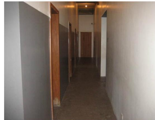
Figura 84 - Corredor das celas após o "restauro". Repare que foi aberto um "dente" na parede da direita. A porta no fundo é apenas um simulacro. Foto: Carlos Beltrão, 2010.
