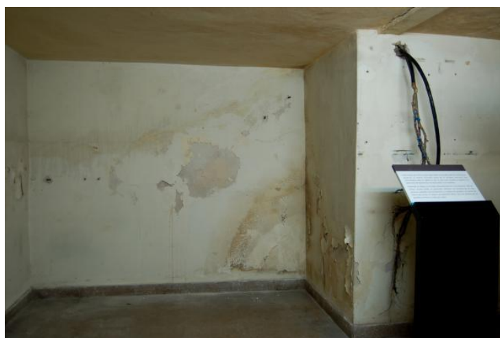
Figura 96 - Local onde ficavam as escadas, hoje encobertas por uma parede de alvenaria. Atenção para o detalhe da umidade que revelou os degraus. Foto: Paula Bugni. (Ramona – Revista de Artes Visuales )
