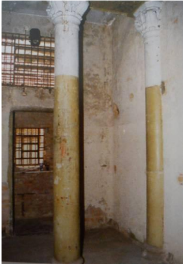
Figura 75 – Imagem da cela antes do início da reforma. Foto: Fernando Braga, 1999. Acervo Arquivo do Estado de São Paulo.
