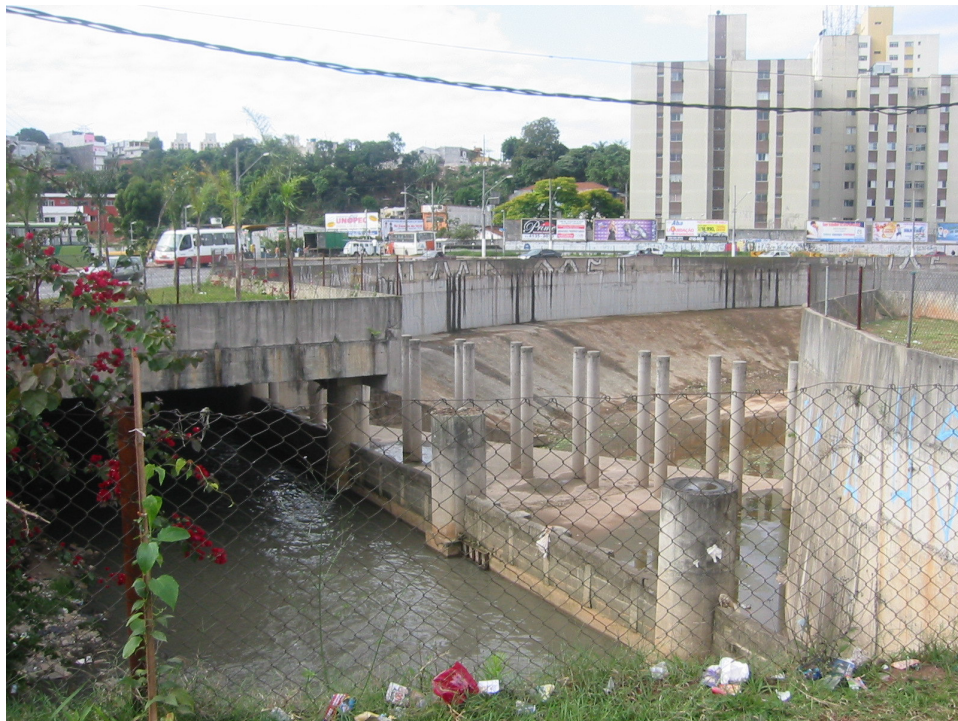
Foto 5. "Piscinão" do Córrego Pirajussara na divisa entre os Municípios de São Paulo e Taboão da Serra ( Rúbia Gomes Morato, 12/10/2008)
