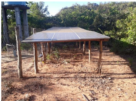
Foto 35 – Comunidade Baixão Fechado: painéis solares instalados
