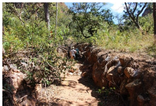
Foto 7 – Melancias: Erosão identificada (2)
