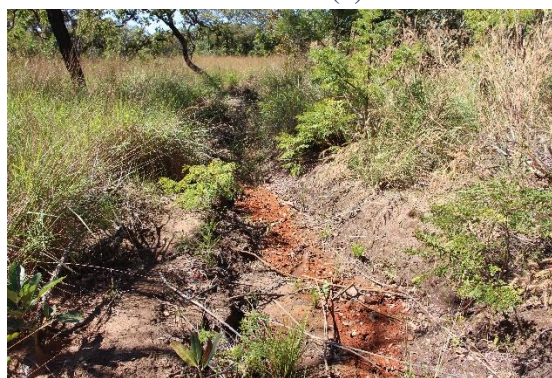
Foto 9 – Melancias: Canal de água assoreado (2)
