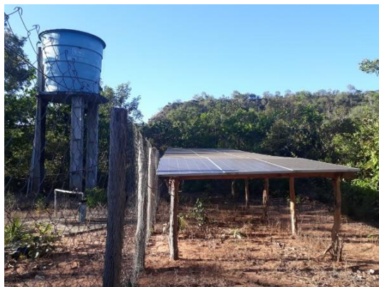
Foto 36 – Comunidade Baixão Fechado: painéis solares instalados
