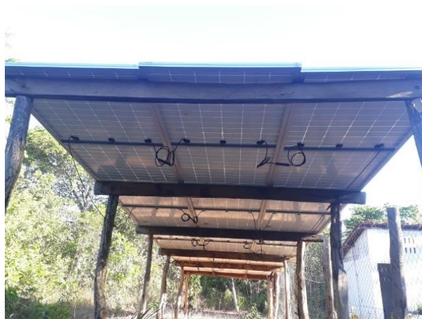
Foto 37 – Comunidade Baixão Fechado: painéis solares instalados
