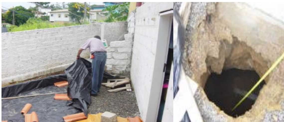
Figura 11 - Buraco surgido no pátio de uma residência - bairro Maria Céu em Criciúma/SC
