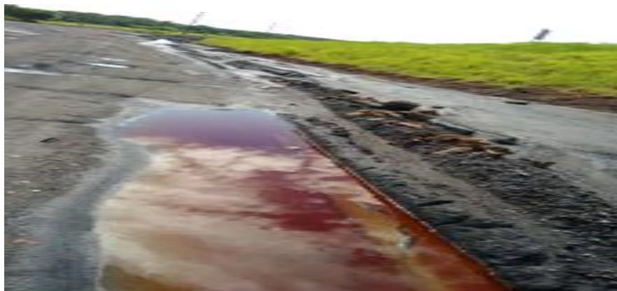
Figura 27- Pavimentação com piritas e poças ácidas-SC
