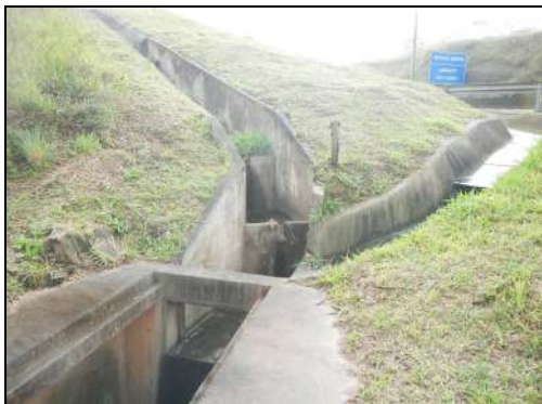
Figura 32. Visão dispositivos de drenagem 1. Dispositivos de drenagem direcionados para caixa coletora na parte inferior da fotografia. Localizada na planície fluvial intersectada pelo acesso Rodoanel – Anchieta.
