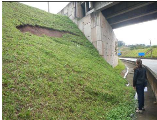
Figura 40 – Registro de processos erosivos 3 Descrição: Deslocamento de material de aterro, associado ao contato com a estrutura de concreto do viaduto. Localização na planície fluvial, no acesso do Rodoanel Mário Covas à Rodovia Anchieta.
