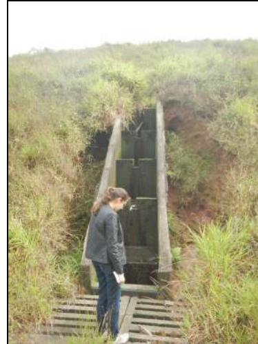
Figura 39 - Registro de processos erosivos 2 Outro ponto com processo erosivo no contato entre escada hidráulica e aterro, localizado na porção central da área de estudo, em planície fluvial intersectada pelo acesso Rodoanel – Rodovia Anchieta.
