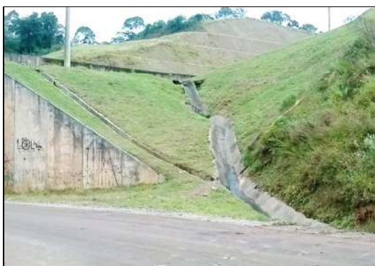
Figura 34. Visão dispositivos de drenagem 3. Dispositivos de drenagem localizadas na planície fluvial da sub-bacia hidrográfica Jd. Vista Alegre, direcionando os fluxos para fora da Rodovia, no sentido da represa.
