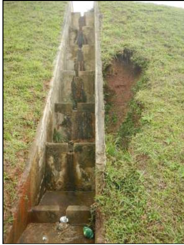
Figura 38 - Registro de processos erosivos 1 Processo erosivo observado na interface entre o material do aterro, na lateral, e o material da escada hidráulica, ao centro. Ponto localizado na planície fluvial, no acesso Rodoanel – Anchieta.
