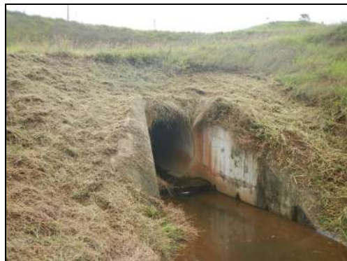
Figura 33. Visão dispositivos de drenagem 2. Manilha de grande calibre, responsável pelo redirecionamento dos fluxos da lateral direita da planície fluvial sobreposta pelo acesso Rodoanel – Anchieta.
