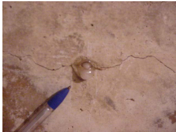
Figura 2.2- Gel exsudado a partir de uma fissura na superfície do concreto. (13)
