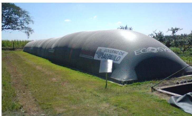
Figura 24: Unidade modelo de biodigestor anaeróbio instalado na ETEC Astor de Mattos Carvalho
