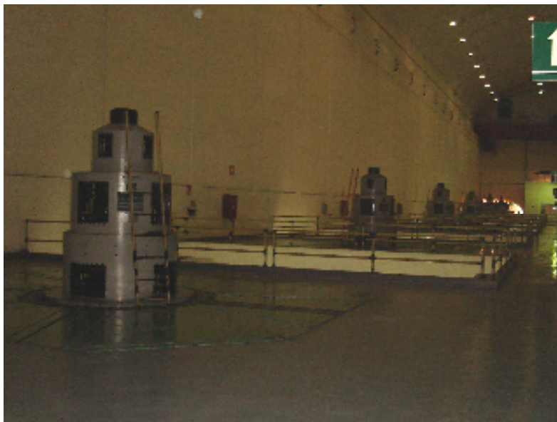
Figura 18: Salão dos geradores da usina subterrânea. Fonte: a Autora 2006.
