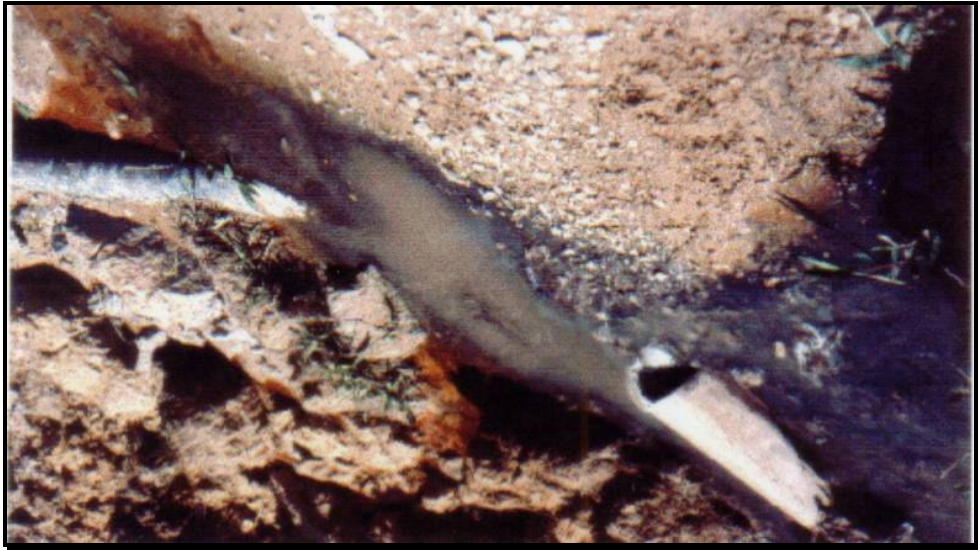
Identificação de pontos danificados da rede de esgoto, em construção
