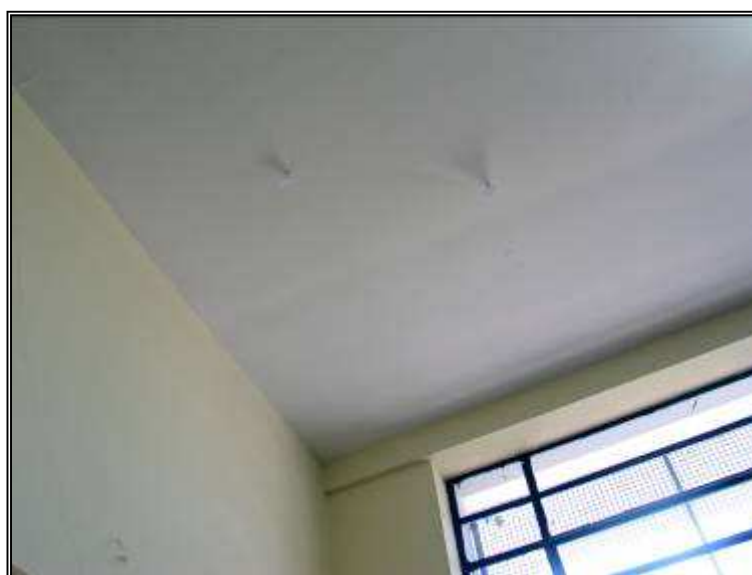
Foto 29- Zarabatana no teto da sala de aula (2007)
