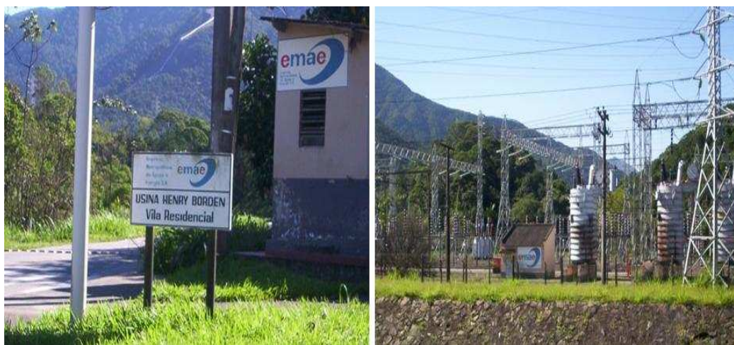
Figura 24 – Uma das entradas da Usina Henry Borden e visão da planta industrial, mostrando geradores elétricos e parte da fiação de distribuição de energia elétrica da Emae. Fonte: arquivo pessoal do autor (2007).
