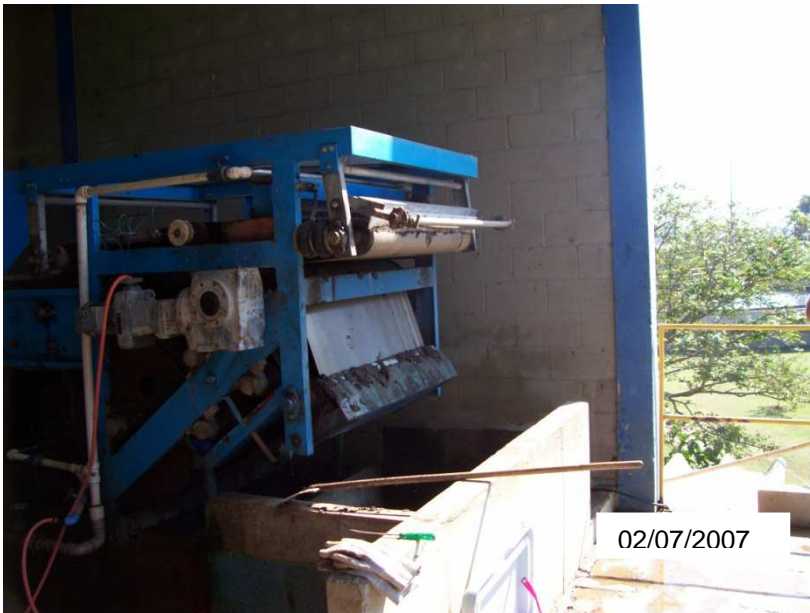
Figura 5: Local de coleta na ETE de Vinhedo, o lodo é prensado na esteira para desaguar e cai em caçamba para ser transportado para destinação final.
