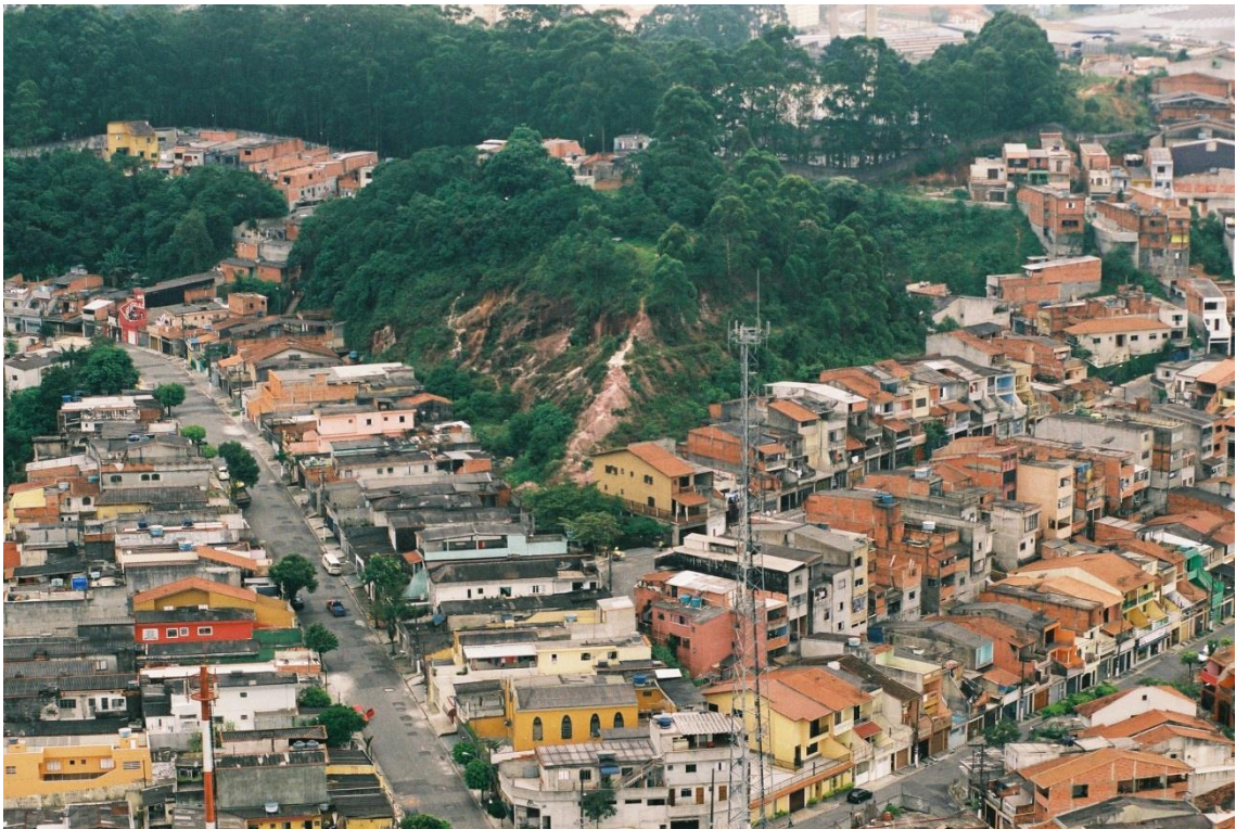
Foto 4.5: Visão do Núcleo São Jorge, moradias instaladas na base de encosta natural com evidências de movimentação, tais como cicatrizes e feições erosivas. (São Bernardo do Campo, 2010b).
