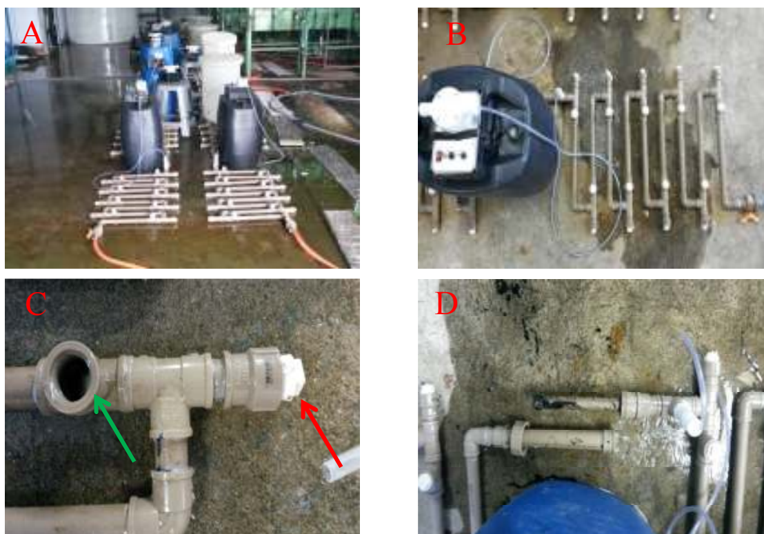
Figura 61 – Unidade de monitoramento da corrosão com dosagem de substâncias. A) Visão geral da unidade de monitoramento; B) Visão superior da unidade de dosagem: reservatório da substância dosada, bomba dosadora e linhas de monitoramento para 9 corpos de prova; C) Visão superior do local de inserção dos corpos de prova (seta vermelha) e introdução dos microeletrodos (seta verde) para determinação dos parâmetros metabólicos dos biofilmes de corrosão; D) Visão superior do misturador de substâncias dosadas.
