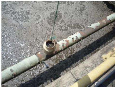
Figura 2 - Recipiente para coleta de lodo de esgoto na Estação de Tratamento
