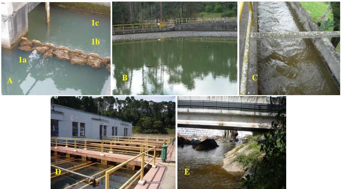
Figura 3 - Pontos de coleta na estação de tratamento de água. A) Pontos de coleta dos tanques de floculação B) Tanque de floculação isolado C) Canal que liga os tanques de floculação aos tanques de filtração D) Filtros de areia e antracito E) Local de coleta do biofilme natural (rochas)
