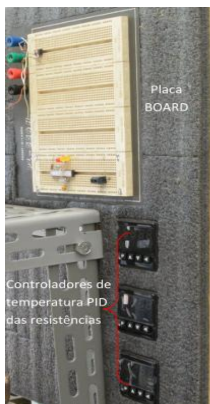
Figura 4.19 Controladores PID de temperaturas para os tubos evaporadores.
