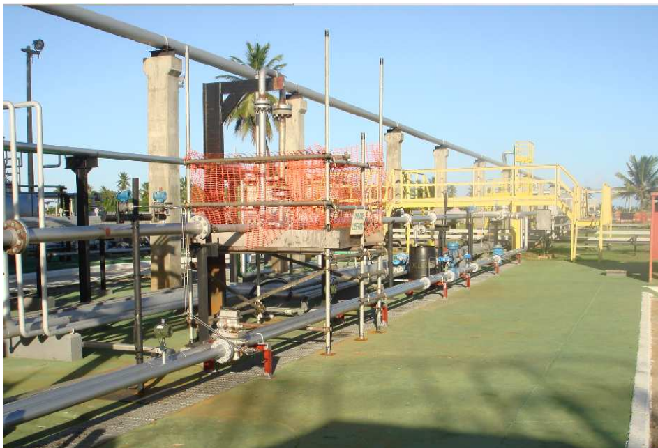
Figura 5.2: Vista parcial da bancada de testes instalada no NuEx em Atalaia.
