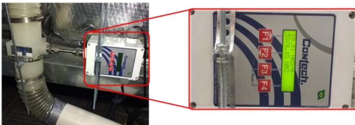
Figura 4.24 - Instalação do medidor de vazão – em detalhe, valor da vazão no sistema personalizado
