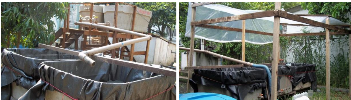
Figura 47 - Leitos de drenagem sem cobertura e tanques de condicionamento elevados (à esquerda) e os 3 leitos com cobertura translúcida (à direita)
