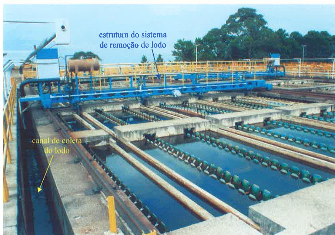
Figura 4.6 – ETA Rio Grande: Sistema de Remoção de Lodo dos Decantadores
