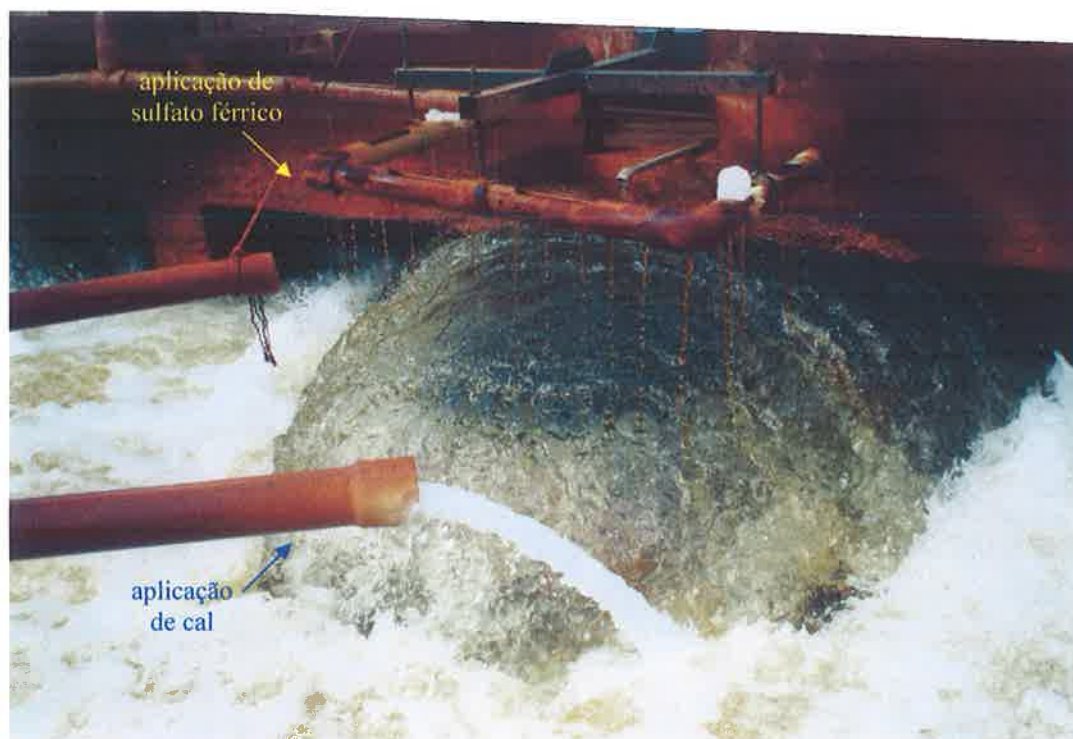
Figura 4.8 – ETA Rio Grande: Ponto de Aplicação do Coagulante
