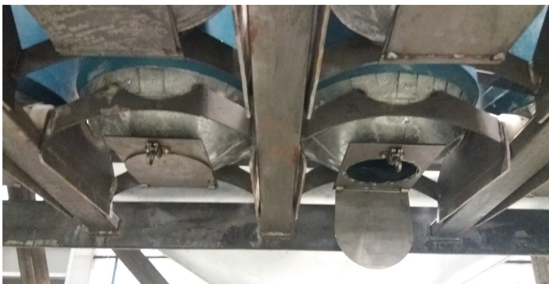
Figura 108 - Vista inferior dos silos, com detalhes das portinholas e gatilhos de abertura.
