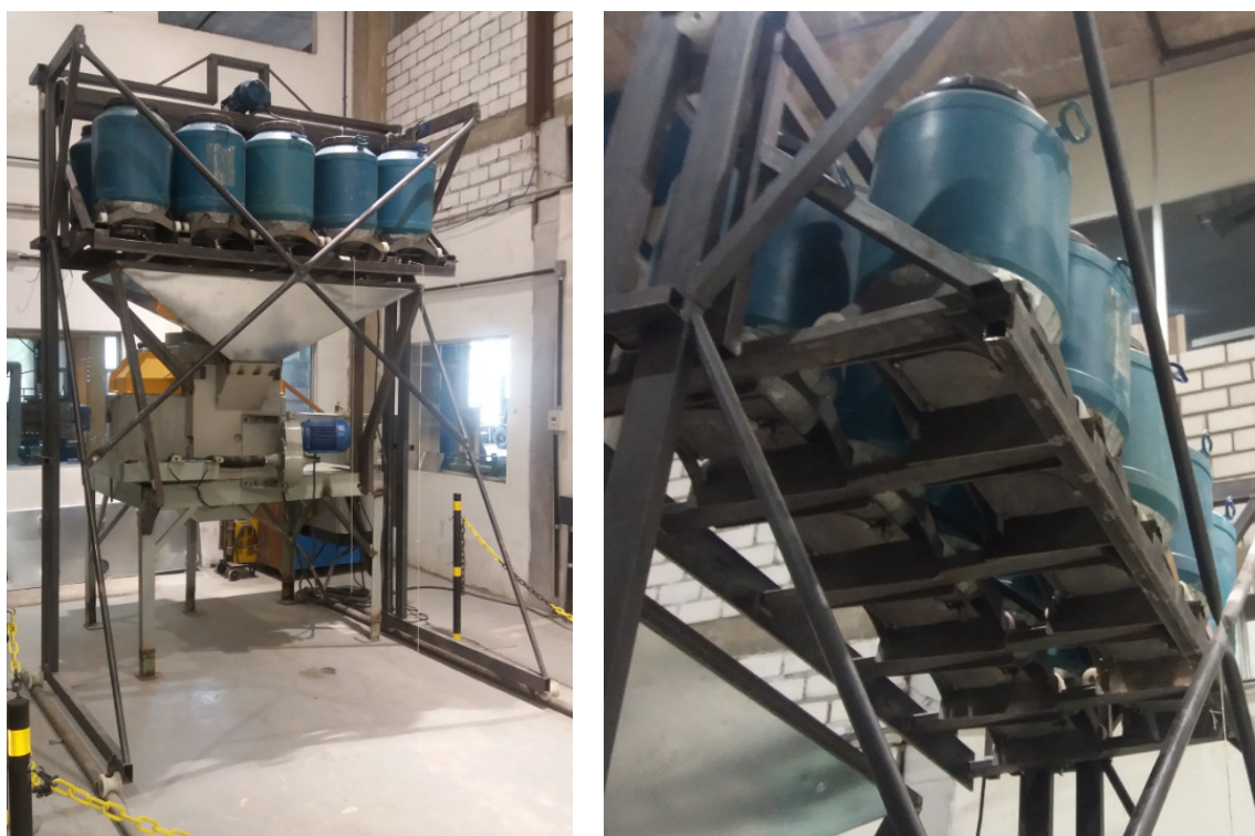
Figura 105 - Sistema de alimentação do misturador instrumentado: vista geral (esquerda) e vista inferior da bateria de mini silos (direita)
