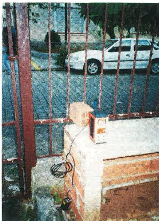
Figura 6.47 – Instalação do pré-amplificador azul e sensor sobre o trecho de tubo de PVC soldável.
