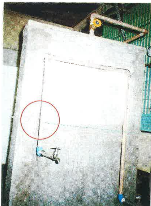
Figura II.2 – Painel hidráulico com vazamento.
