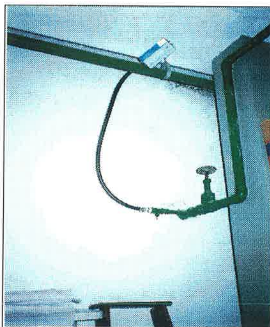
Figura 6.4 – Data logger instalado em um dos ramais do subsolo do InCor.
