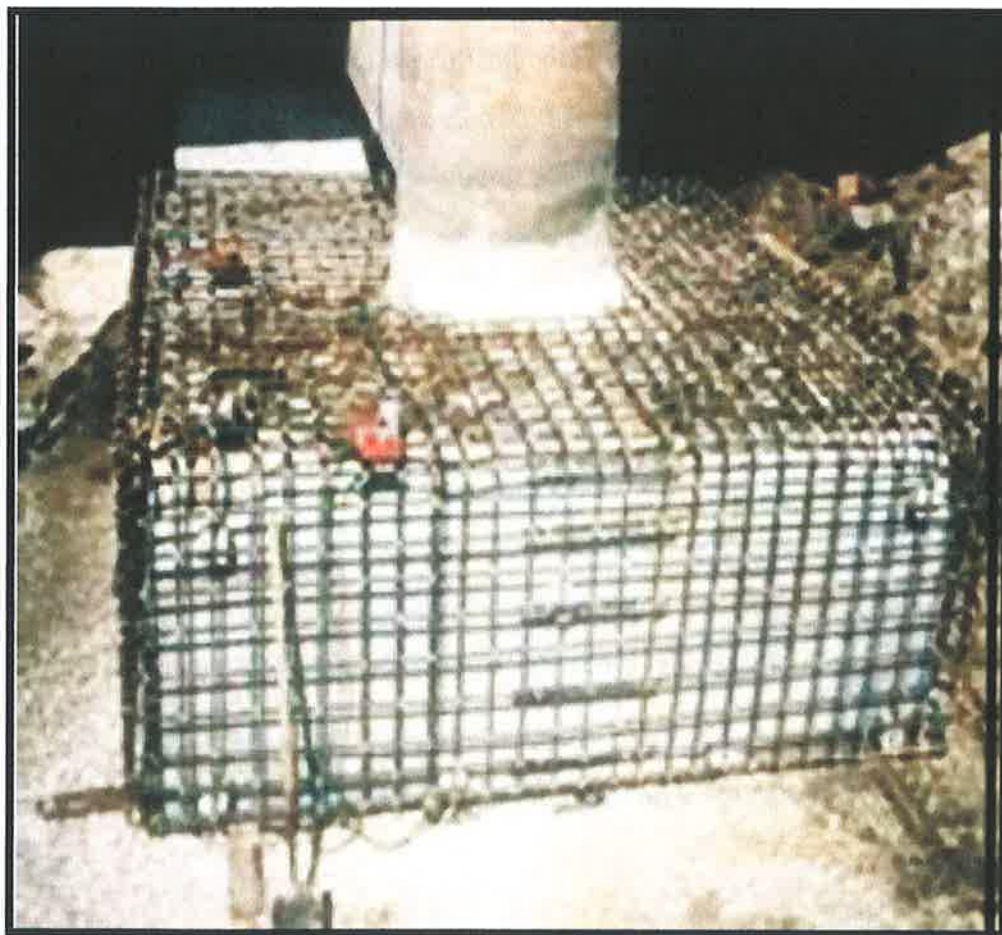
Figura 2-4 – Exemplo de um ânodo de sacrifício na forma de malha, aplicado em uma estrutura real (GONÇALVES et AL., 2003)
