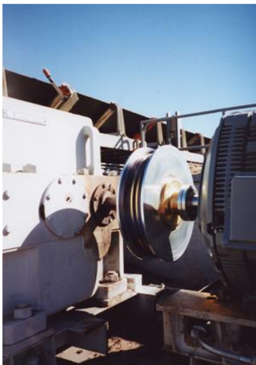
Figura 1.5 – Exemplo de aplicação do acoplamento magnético: esteira transportadora [32]
