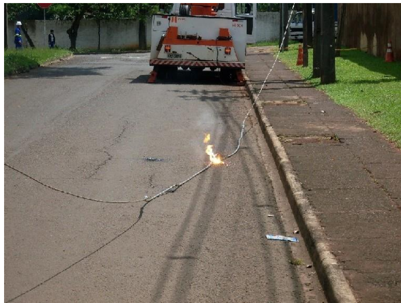
Figura 15 – Curto circuito fase terra – cabo sobre asfalto
