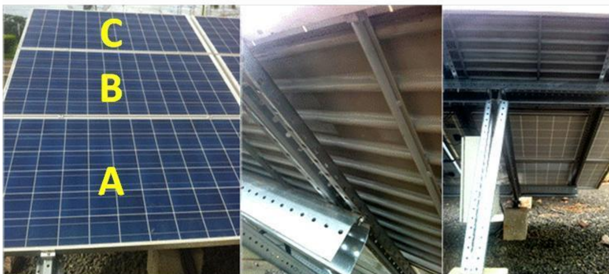
Figura 85 - Módulo PV com UMAr instalada na UFVa.
