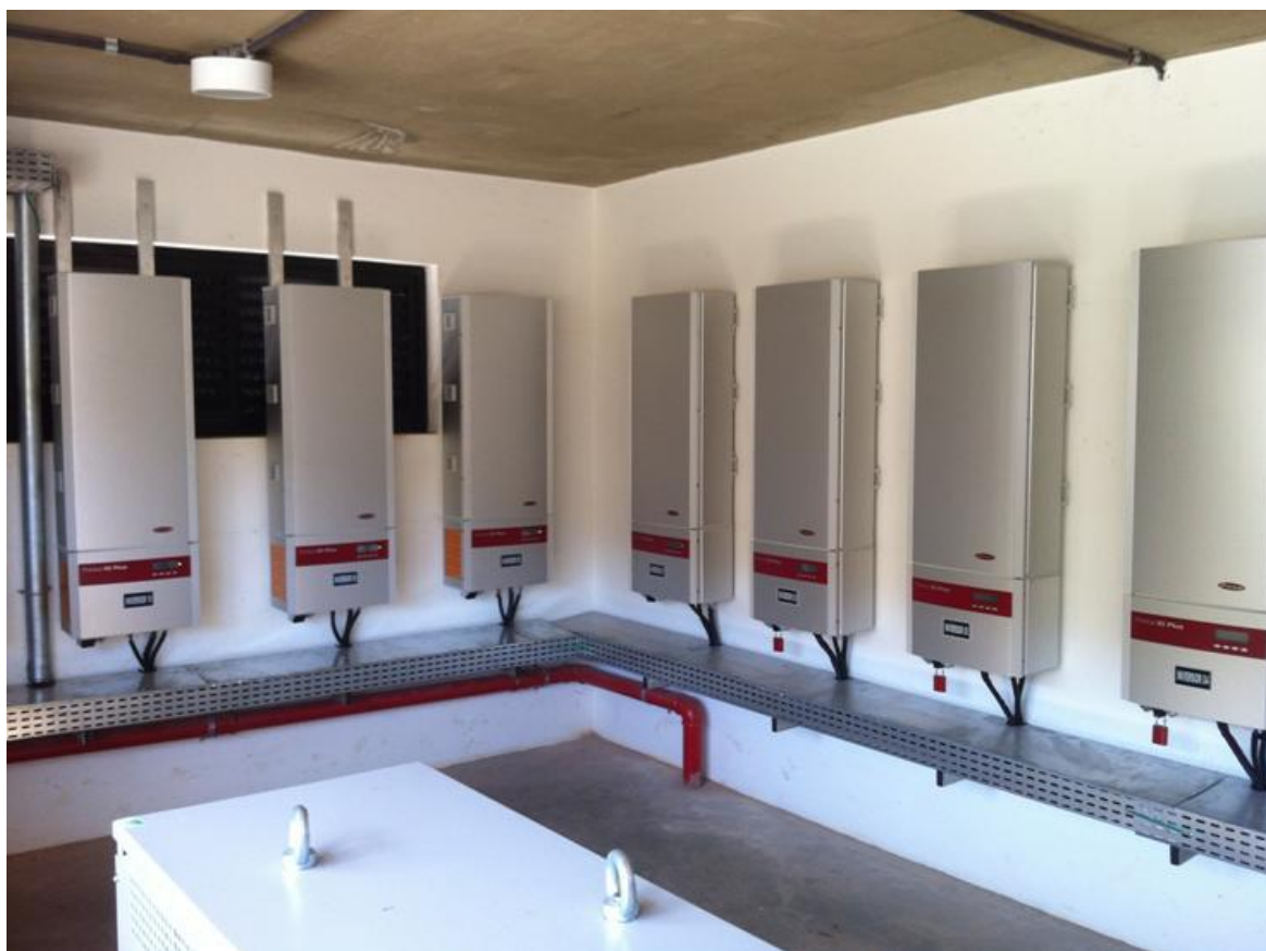
Figura 33 – Inversores instalados na sala de inversores da UFVa-ILS.
