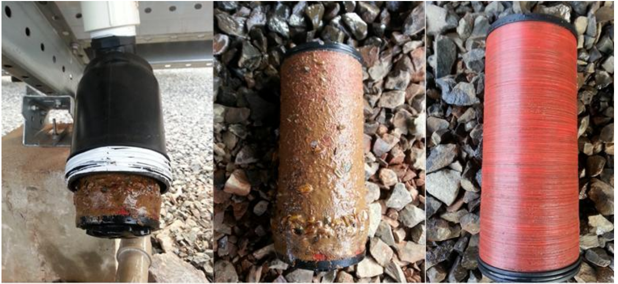
(a) (b) (c) Figura 87 - Filtro da linha A. (a) Filtro conectado a linha A, (b) filtro sujo e (c) filtro limpo.
