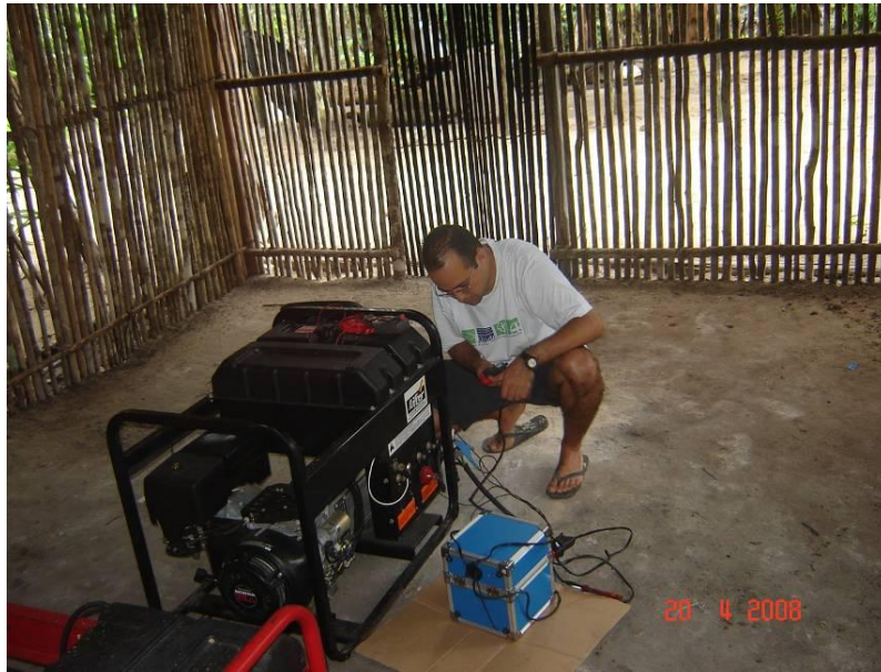
Figura 17 – Local de instalação do gerador 1 de 7,2 kVA do Centro Cirúrgico
