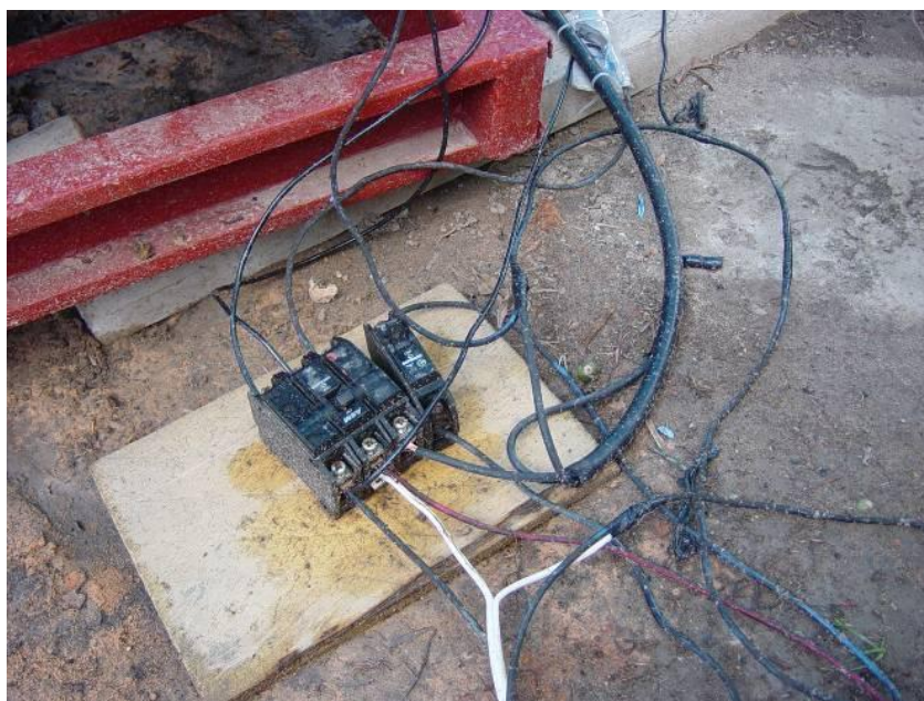
Figura 52 – Instalação de disjuntores e fiações expostas
