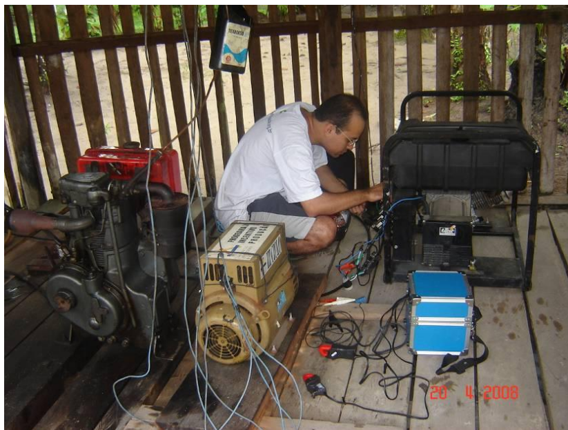
Figura 18 – Arranjo para medição de grandezas elétricas no gerador 2
