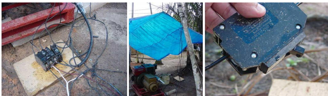
Figura 26 – Exemplo de ligações emergenciais para utilização de gerador da comunidade
