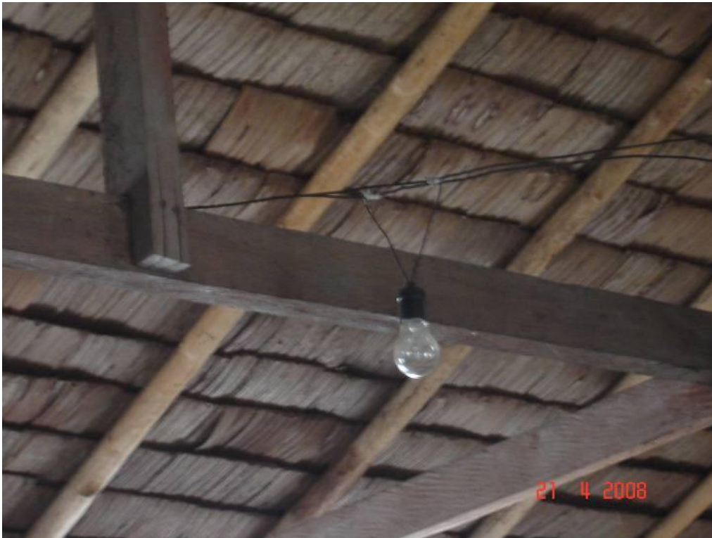
Figura 29 - Iluminação incandescente: o tipo mais encontrado nas instalações
