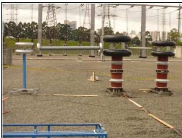
Figura 47 - Divisor capacitivo e reatores utilizados na prova de tensão aplicada.
