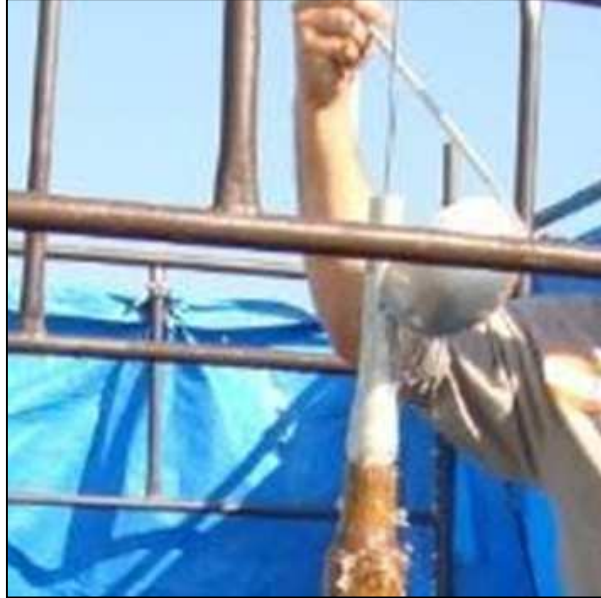
Figura 72 - Ponta do cabo recebendo banho de óleo LAB.
