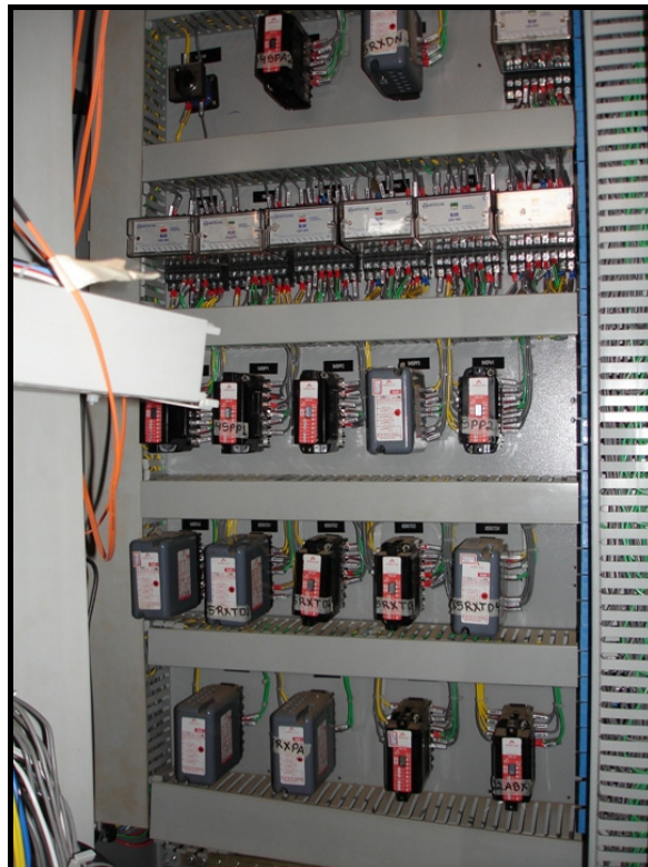
Figura 17 – Quantidade de relés auxiliares no painel de linha de transmissão
