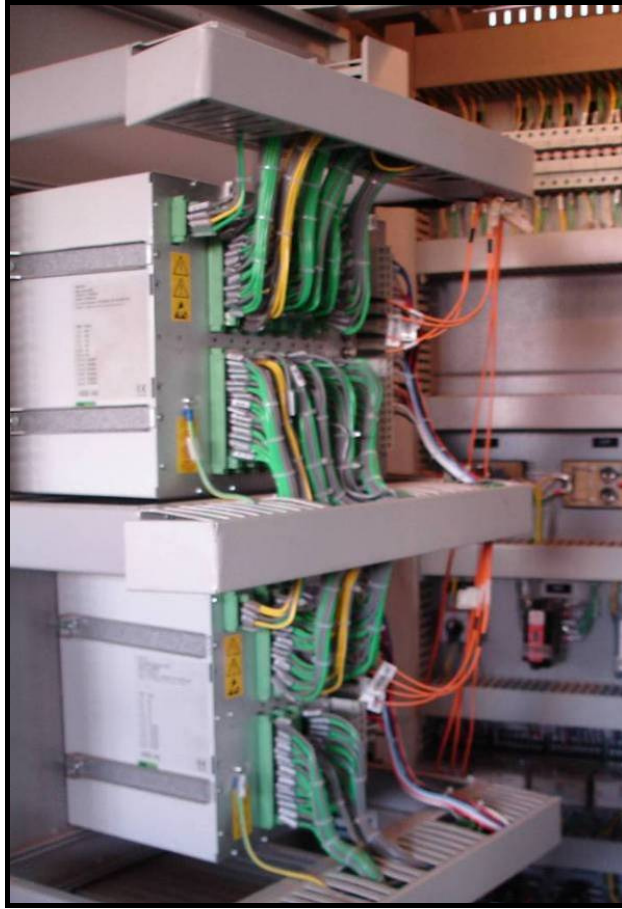
Figura 12 – Quantidade de cabos nas entradas e saídas dos IEDs
