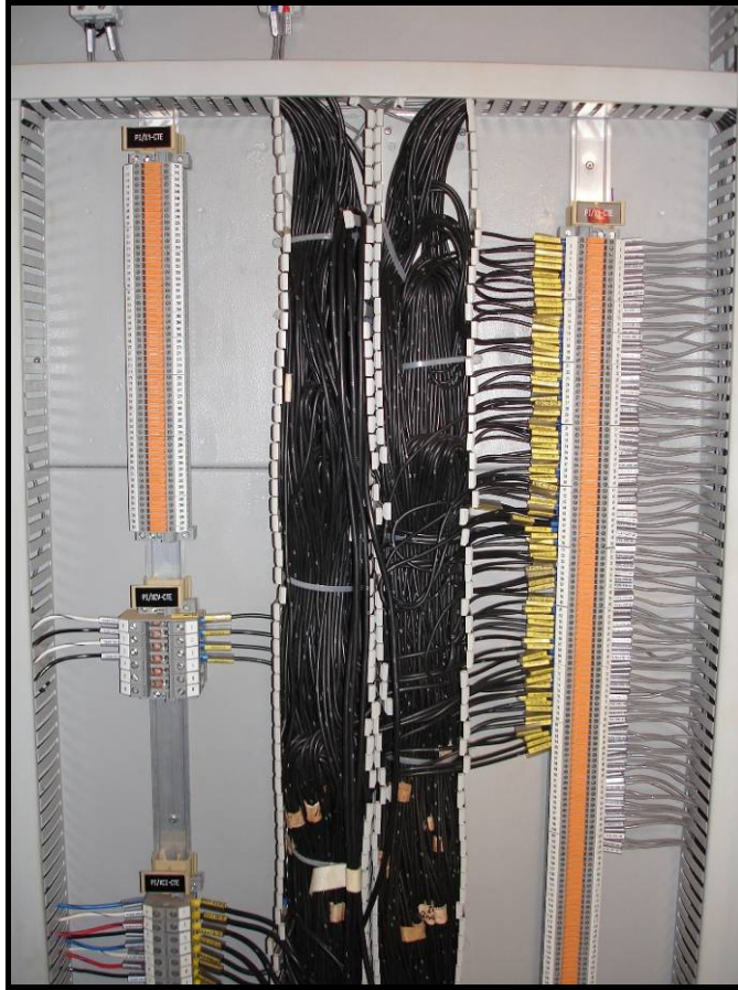
Figura 11 – Painel de interface com pontos de proteção, supervisão e circuitos de tensão e corrente
