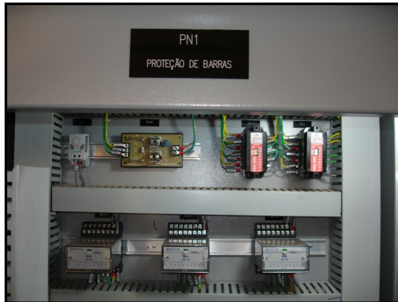
Figura 18 – Relés auxiliares no painel da proteção de barras
