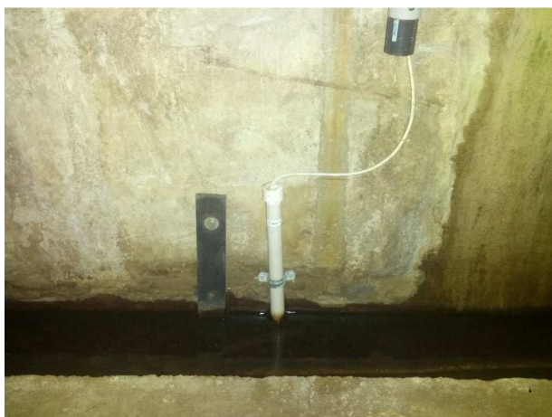
Figura 9 – Medidor de Vazão instalado
