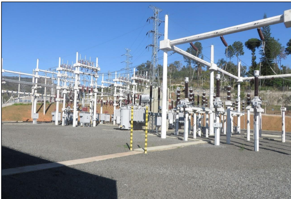
Figura 20 – Pátio da Subestação Morungaba II
