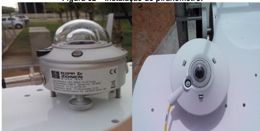
Figura 62 – Instalação do piranômetro.
