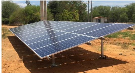
Figura 39 – Sistema FV instalado em estrutura fixa.
