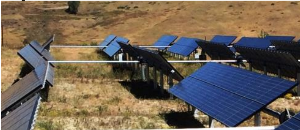
Figura 38 – Sistema FV instalado em estrutura com rastreamento solar.
