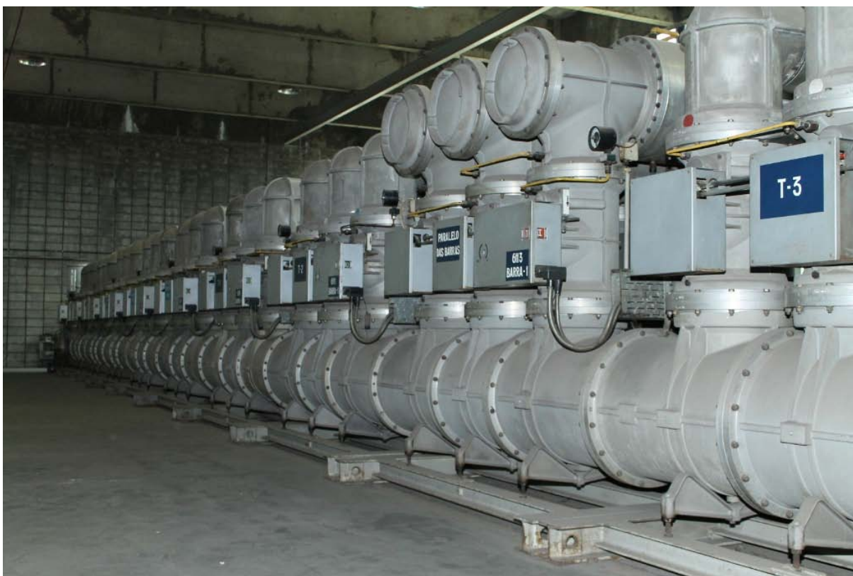
Figura 3: Subestação Paula Souza (AES Eletropaulo)
