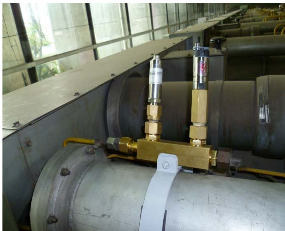
Figura 10: Sensores instalados (disjuntor)
