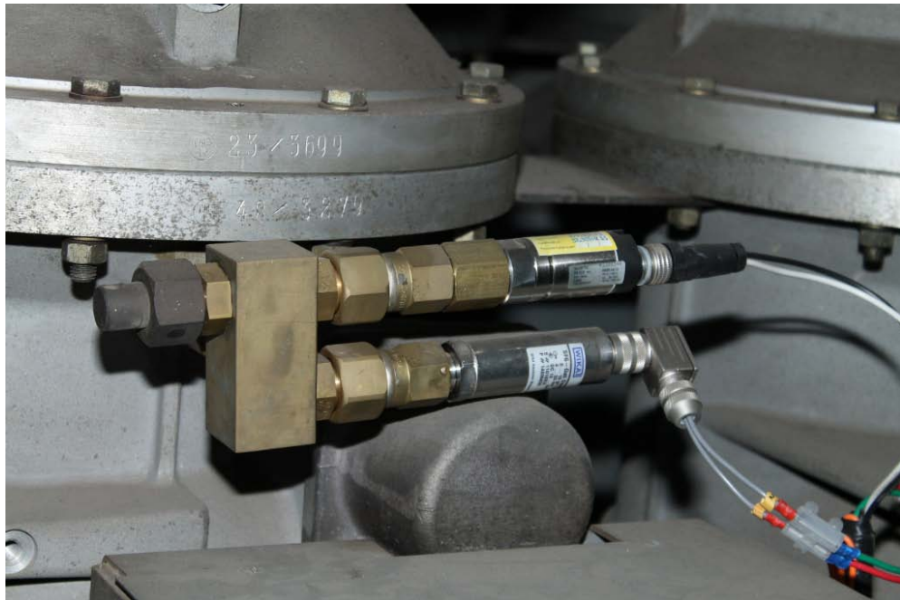
Figura 9: Sensores instalados (ponto central do bay)
