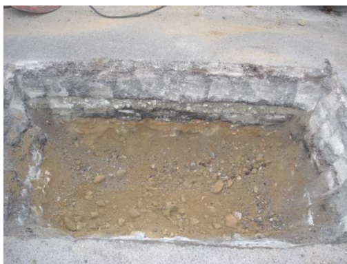
Figura 131 - Cava no pavimento do trecho T01
