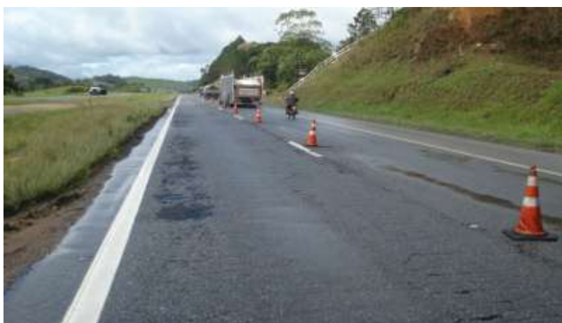
Figura 39 – Deformação permanente em trilha de roda no trecho experimental antes da restauração
