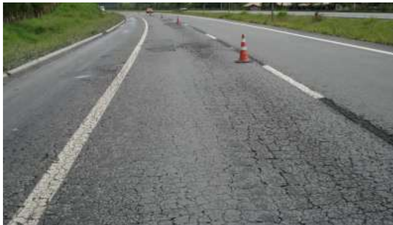
Figura 38 – Trincamento existente no trecho experimental antes da restauração
