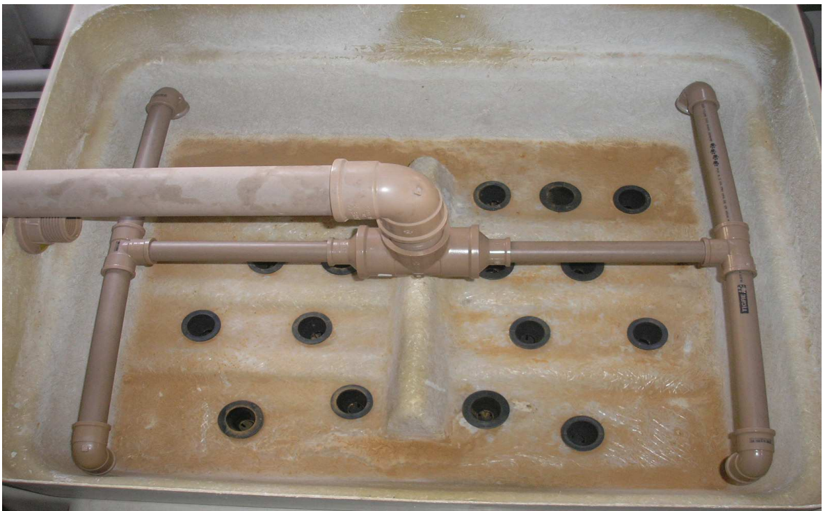
Figura 2.5 - Distribuidor construído com tubos de PVC na entrada das torres TR-01 e TR-02.
