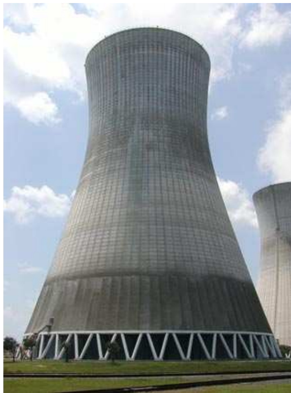
Figura 1.3 - Torre de resfriamento hiperbólica com circulação natural. (COOLING TOWER DESIGN, 2011)
