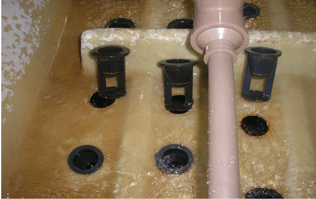
Figura 1.8 - Distribuição por gravidade. A água é coletada em uma bacia e os orifícios possuem estruturas de aspersão para evitar escoamento preferencial. Nesta foto, algumas destas estruturas foram removidas de seus orifícios.
