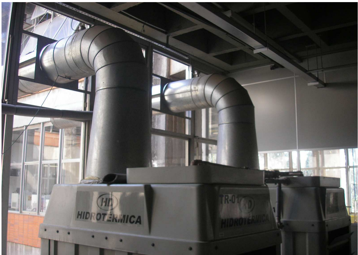
Figura 2.3 - Dutos de escoamento de ar das torres de resfriamento TR-01 e TR-02.
