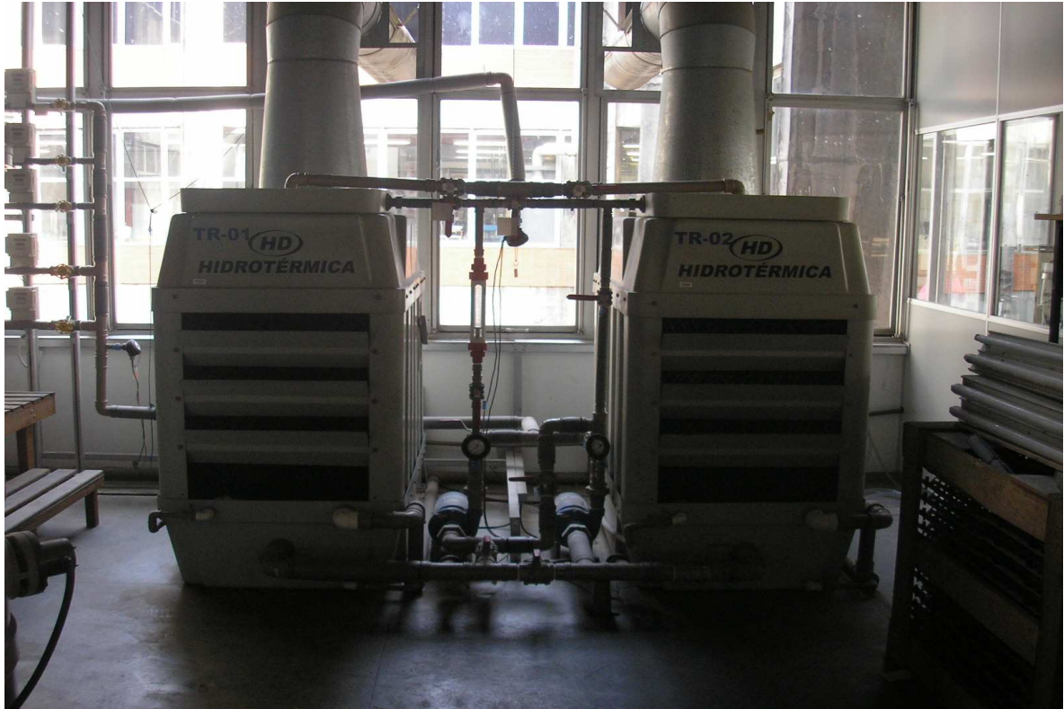
Figura 2.2 - Sistema de resfriamento com as torres TR-01 e TR-02.
