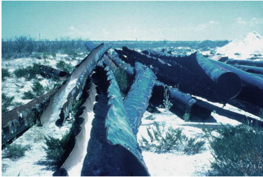
Figura 1.2: Exemplo de colapso catastrófico de um gasoduto operando a baixa temperatura
