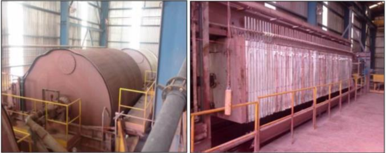
Figura 33. Filtro rotativo a vácuo da usina de Vazante
