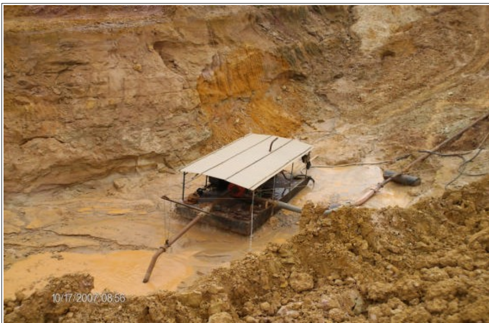
Foto 3.10 – Bacia de acumulação com a draga que realiza a sucção do material desagregado (polpa) e envio para o beneficiamento. (Foto: autor).
