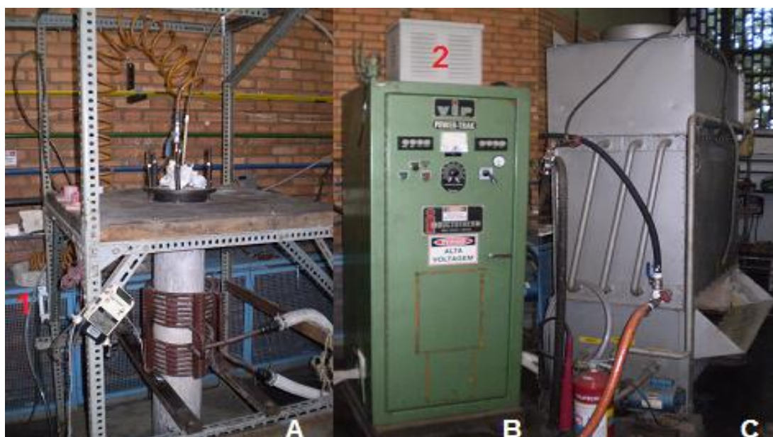
Figura 45. Vista do forno de redução e do conjunto de equipamentos auxiliares para seu funcionamento: (A) forno de indução, (B) controlador da potencia e (2) transformador de voltagem, (C) Torre de refrigeração.
