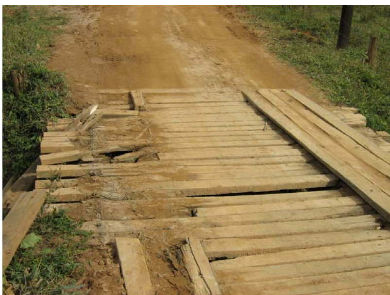
Figura 16 – Estrada do Paraibuna: Ponte em precário estado de conservação
