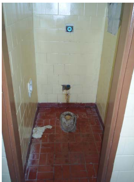
Figura 8 Depredação do vaso sanitário do banheiro da UE 3, ocasionado por bomba caseira.
