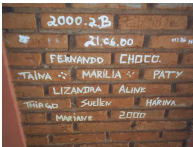
Figura 10 Pichações nas paredes da UE 2 – vandalismo.
