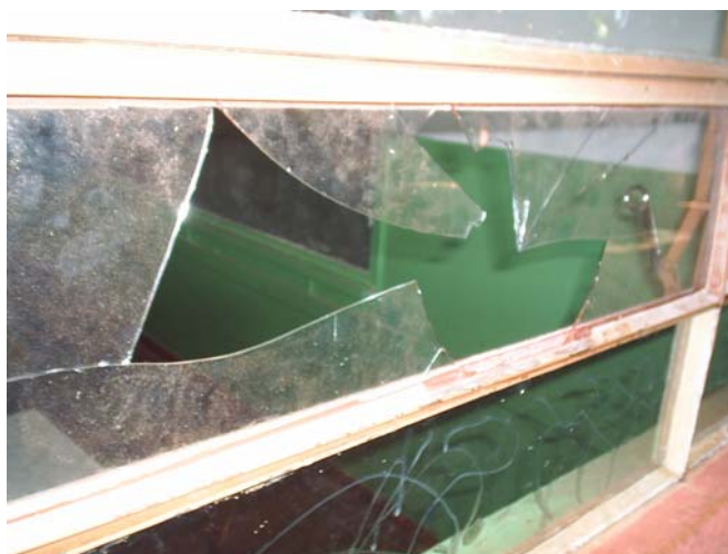
Figura 13 Vidros quebrados de uma sala de aula da UE 9 – vandalismo.
