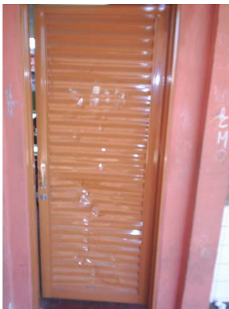
Figura 14 Porta de uma sala de aula, da UE 9, amassada por chutes dos alunos – vandalismo.
