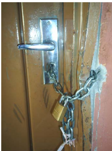
Figura 18 Porta da sala da diretoria da UE 3, após ter sido arrombada e roubado equipamentos de informática, trancada de forma improvisada pelo fato dos invasores, quase terem arrancado o portal da parede.
