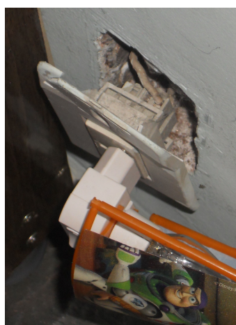
Figura 17 - Elemento: tomada e fio exposto. Autor: Eduardo
