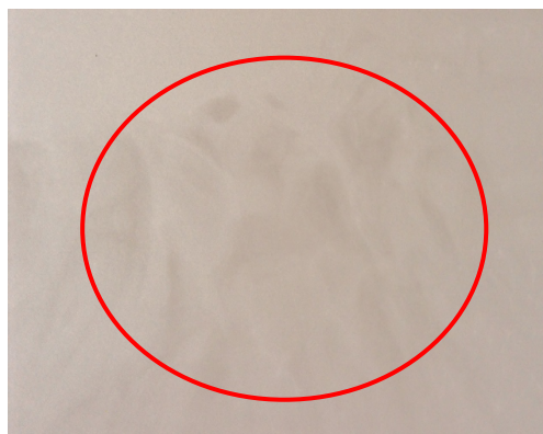
Figura 6 - Local acima do acidente. Detalhe das marcas da explosão do botijão de gás no teto da cozinha. Família do Eduardo. Autor: Eduardo
