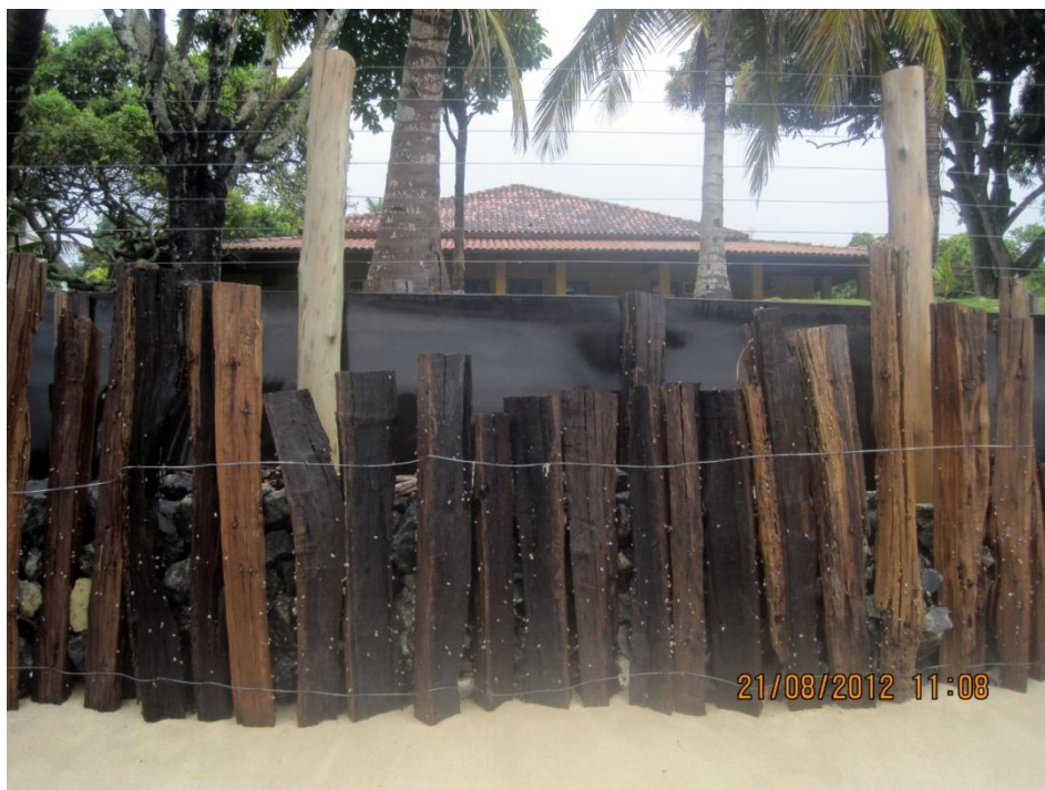
Figura 38: Pequena intervenção estrutural para tentar conter o avanço da erosão costeira, em Cumuruxatiba (BA). Foto: Juliana S. Ribeiro
