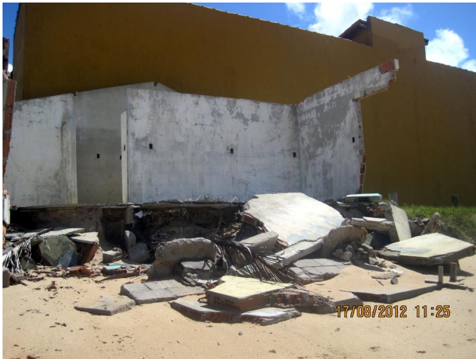
Figura 23: Imagem dos destroços de uma das construções urbanas destruídas pela erosão costeira em Mucuri (BA). Fotos: Juliana S. Ribeiro
