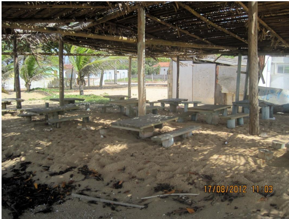
Figura 22: Evidência de erosão costeira – soterramento de quiosque em Mucuri (BA). Foto: Juliana S. Ribeiro
