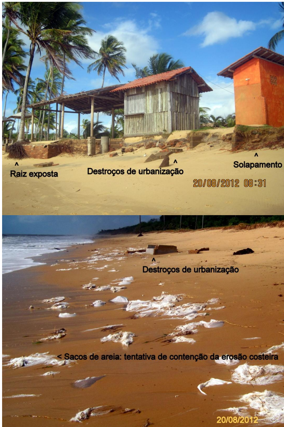
Figura 34: Evidências de erosão no trecho sul percorrido em Prado (BA). Nota-se a presença de raiz exposta, destroços de urbanização e solapamento, além de sacos de areia colocados na tentativa de conter o avanço da erosão costeira. Fotos: Juliana S. Ribeiro
